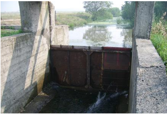
Рис. 1 – Шлюз-регулятор на осушительной системе
