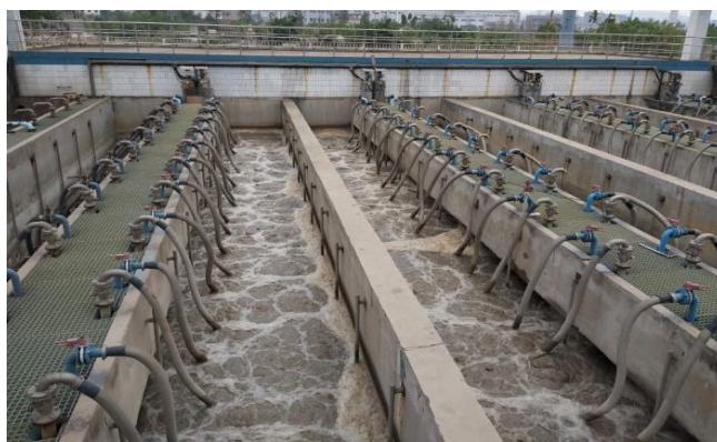
Рисунок 1 – Сточные воды свинокомплекса в аэротенках первой ступени очистки, 1996 г. Figure 1 – Pig farm wastewater in aeration tanks of the first stage of treatment, 1996.
